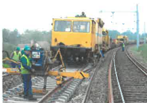
Longs Rails soudés sur traverses béton
